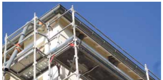
Installation des nichoirs doubles pour les hirondelles lors de travaux d'isolation thermique à Chavanay.
